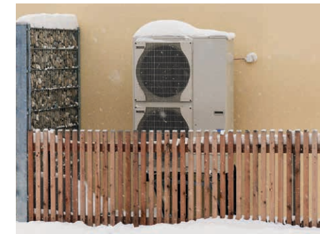
Luft-Wärmepumpe mit Lärmschutz
